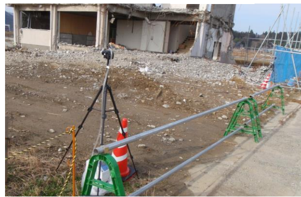
石綿大気濃度調査の例(損壊建築物近傍)
